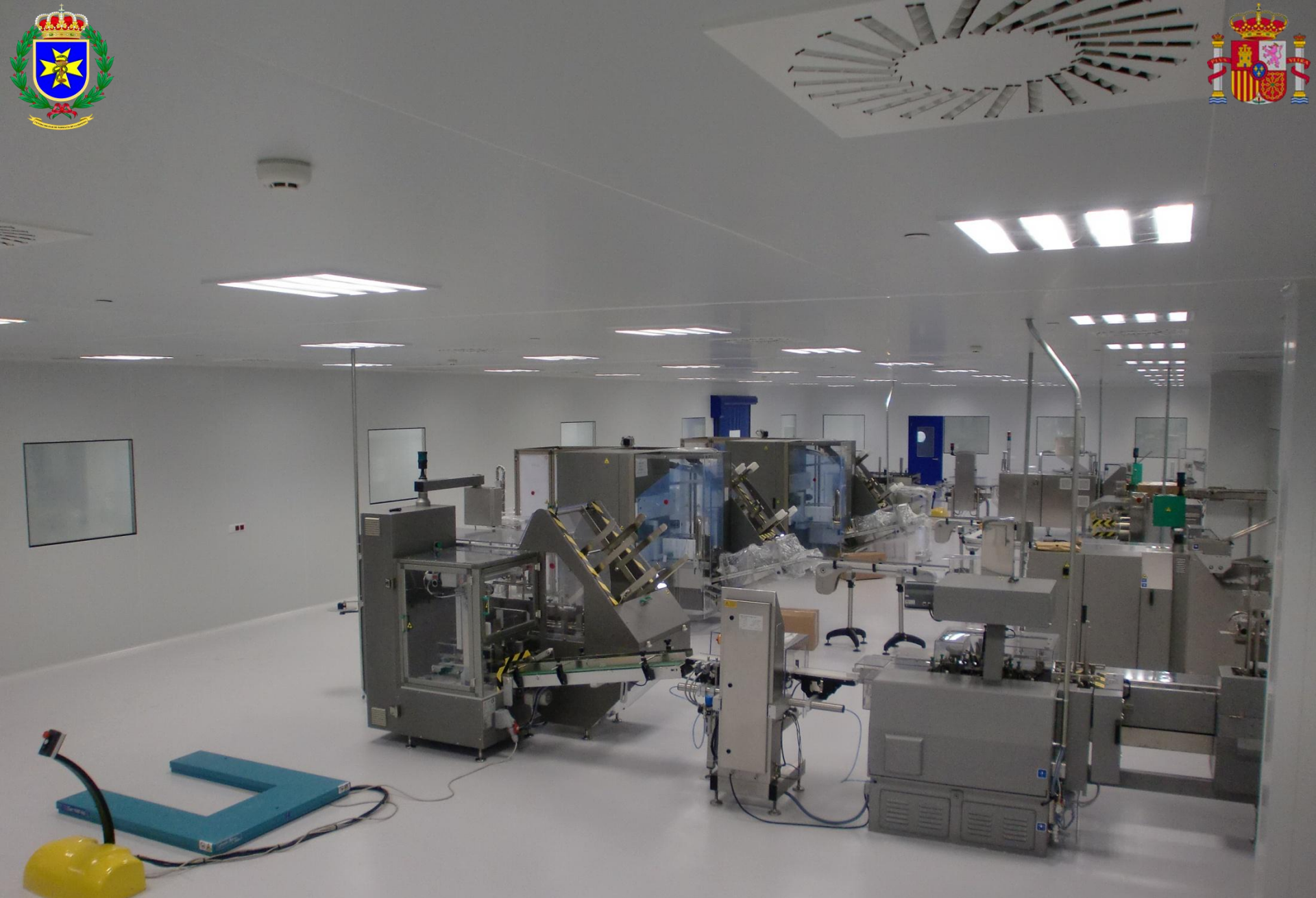
SALA DE ACONDICIONAMIENTO DE CÁPSULAS Y COMPRIMIDOS Estuchado y encajado de Yoduro potásico DEF
